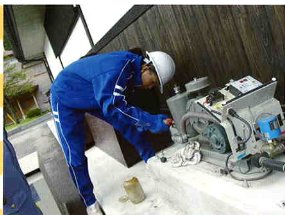
浄化槽のプロワターの点検
